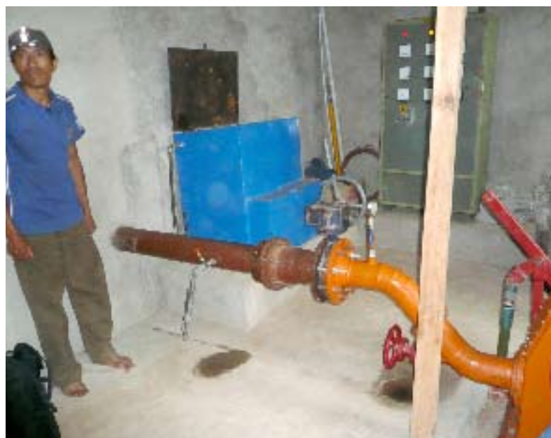
Kontrollrommet til mikrokraftverket og mannen som driver det.
