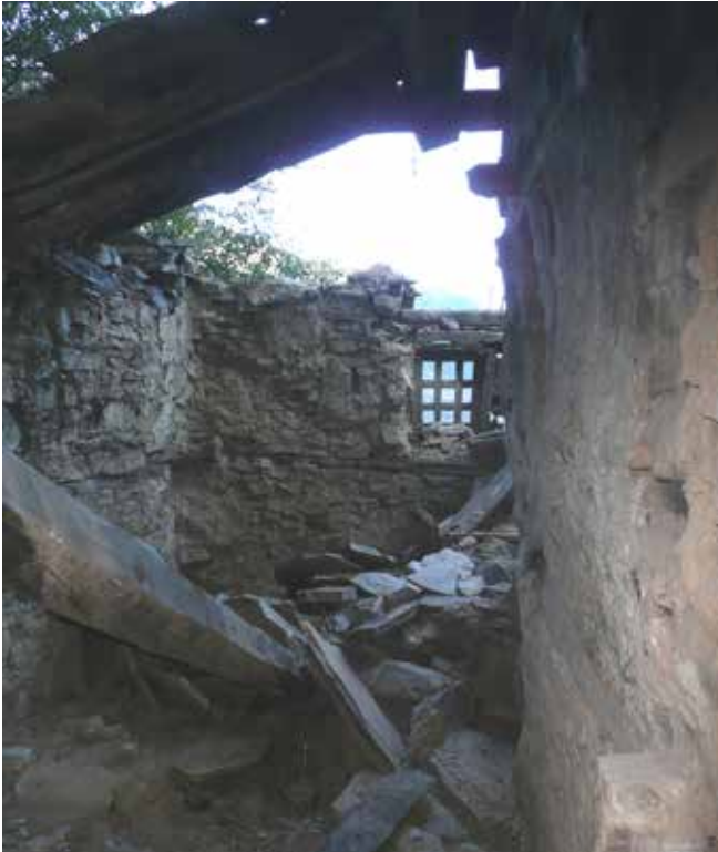
Templet i 2011 med det ødelagte taket. Foto: Dag Norling
